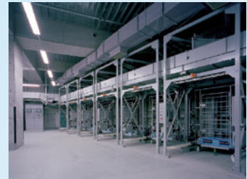
ごみ分別収集ステーション (関電ビル)
